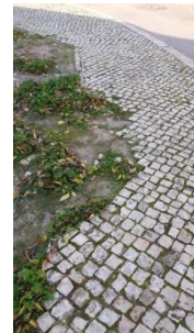
Figura 36 - Pedras de calçada soltas
