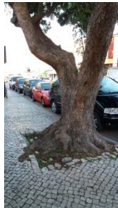
Figura 35 - Pavimentos irregulares e destruídos devido à ação das raízes das árvores
