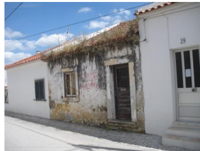
Figura 5 – Exemplo de edifício com patologia muito grave ao nível da estrutura
