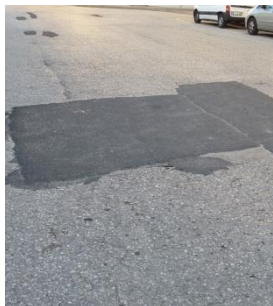
Figura 37 - Pavimentos irregulares, derivado a várias intervenções
