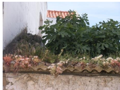
Figura 6 – Exemplo de edifícios com patologia muito grave ao nível da cobertura
