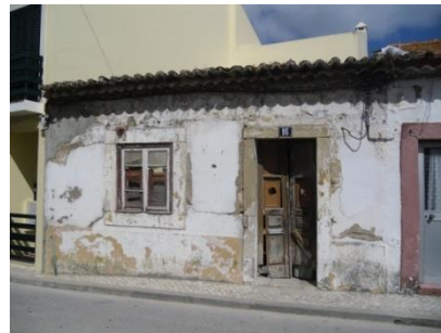
Figura 8 - Exemplo de edifícios com patologia muito grave ao nível da caixilharia
