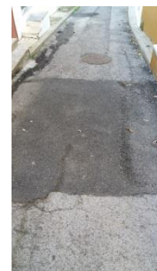
Figura 39 - Pavimento betuminoso em mau estado de conservação.
