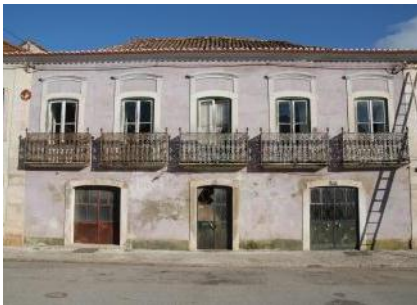
Foto 62 – Edifício degradado na Praça Oliveira Marreca
