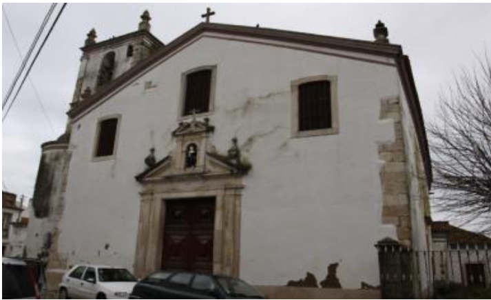
1. Fachada principal da Igreja de Santa Iria grau de degradação
