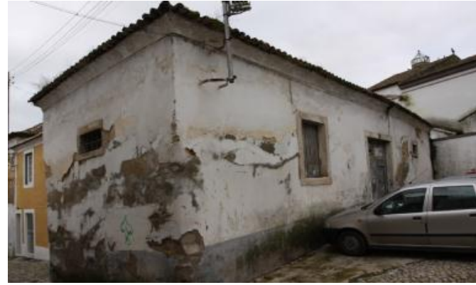
2. Fachada em mau estado de conservação
