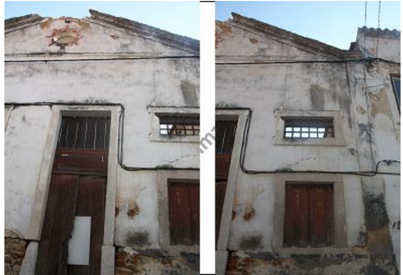
2. Pormenor do estado de ruína da fachada e cobertura
