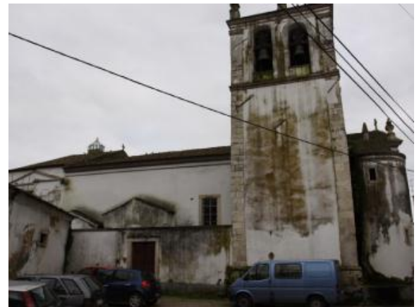
2. Fachada lateral com elevado grau de degradação
