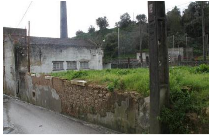
3. Ruína do edifício da Estrada de
