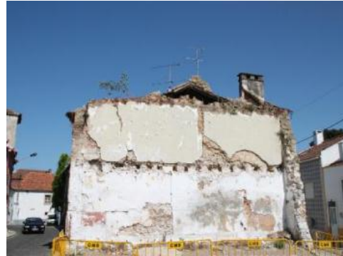
Cobertura em ruína e parte da estrutura degradada
