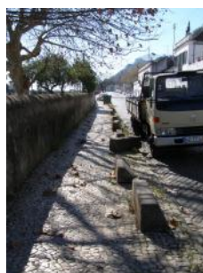
Foto 36 – Passeio com falta de manutenção (estão em falta inúmeras pedras da calçada)
