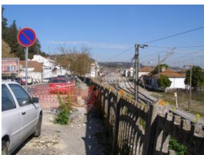
Foto 35 - Passeio de acesso à estação ferroviária interrompida
