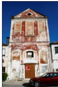
Foto 63 – Edifício Degradado na Praça Oliveira Marreca
