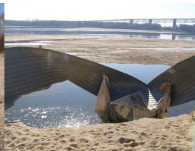
Foto 9 – Vista interior da piscina em total degradação
