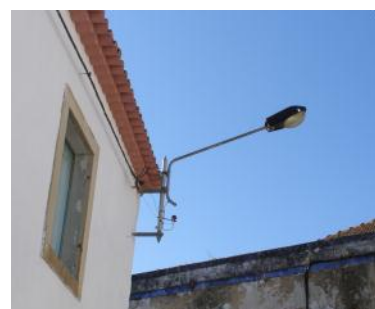
Foto 40 - Iluminação pública de fachada
