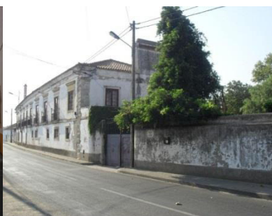
Foto 35 – Edifício com valor arquitetónico em mau estado de conservação a ladear o arruamento principal de Azinhaga
