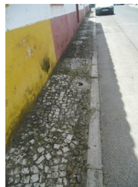
Foto 27 – Passeios em mau estado de conservação
