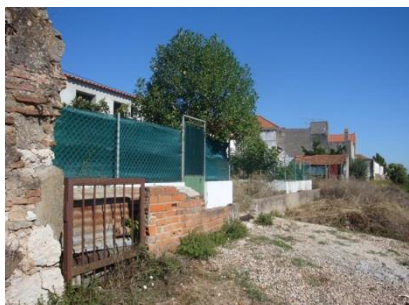
Foto 17 – Margens do Rio Almonda – Situações de tardoz
