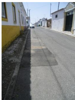
Foto 26 – Pavimento dos arruamentos com irregularidades
