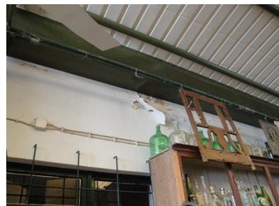
Vista interior e respetivas patologias
