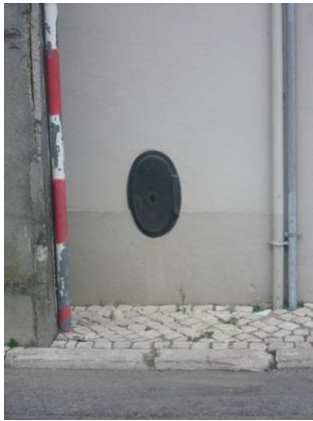
Figura 25 – Foto boca de incêndio
