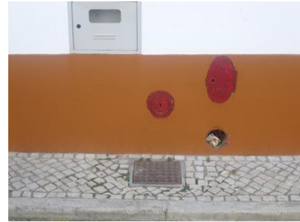
Figura 26 – Foto caixa contador AG
