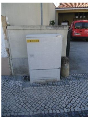
Figura 27 – Foto armário distribuição
