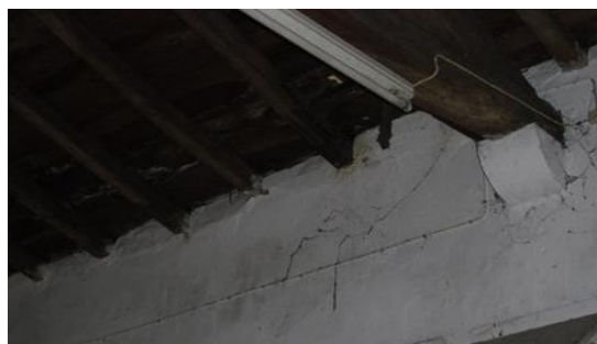
Vista interior e respetivas patologias
