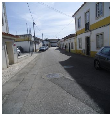
Figura 40 – Vista de via circulação veículos com degradação no pavimentos por intervenções
