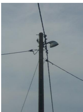
Figura 29 – Cablagens suspensas e luminárias aplicadas em postes fachadas
