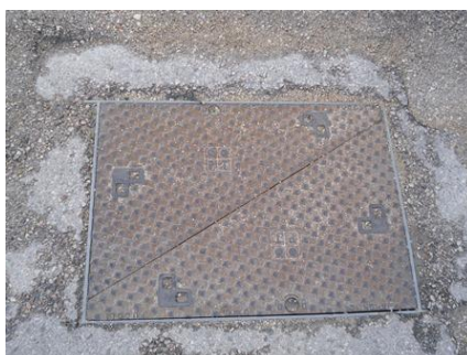
Figura 30 – Câmara de visita de telecomunicações
