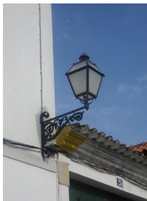
Figura 28 – Cablagens suspensas e luminárias aplicadas em fachadas
