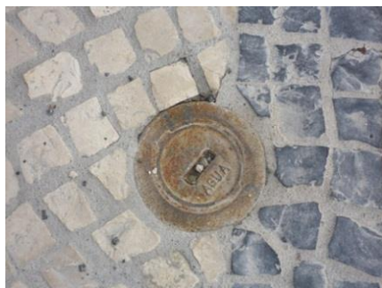
Figura 23 – Foto tampa válvula seccionamento rede AG
