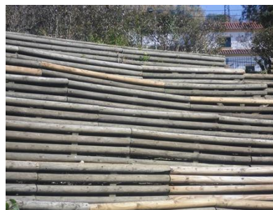
Figura 43 – Bancada do anfiteatro danificadas
