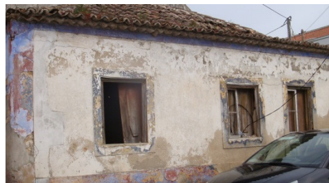
Foto 11: Exemplo de edifício sem caixilharia
