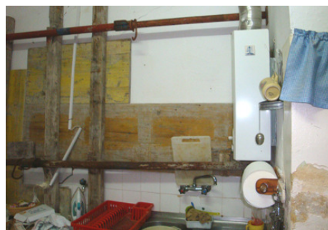
Foto 12: Exemplo de edifício com risco de desabamento
