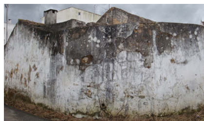
Foto 8: Exemplo de edifício de estrutura deformada
