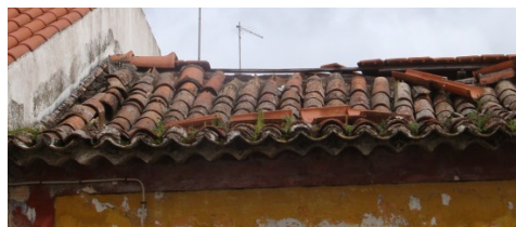
Foto 9: Exemplo de edifício de cobertura danificada
