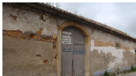
Foto 10: Exemplo de edifício de fachada degradada
