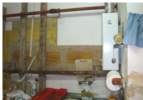
Foto 12: Exemplo de edifício com risco de desabamento
