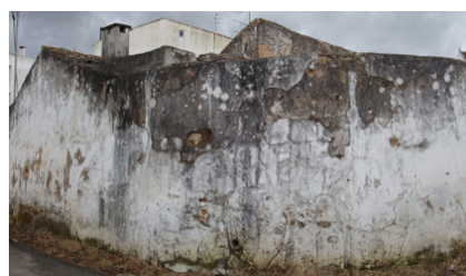
Foto 8: Exemplo de edifício de estrutura deformada
