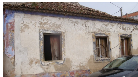
Foto 11: Exemplo de edifício sem caixilharia
