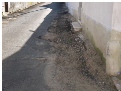
Figura 20 – Inexistência de passeios
