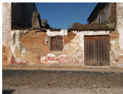
Figura 32 – Degradação do edificado
