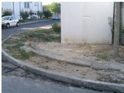
Figura 19 – Passeios em mau estado
