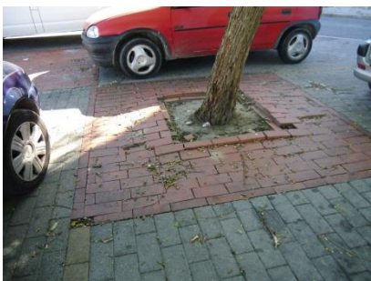
Figura 19 - Pavimento em mau estado de conservação
