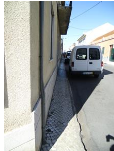
Figura 26 - Rua das Milheiras – passeios estreitos
