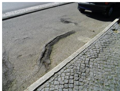
Figura 20 - Asfalto destruído devido à acção das raízes de árvores circundantes
