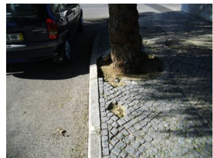
Figura 21 - Pedras soltas nos passeios e caldeira destruída
