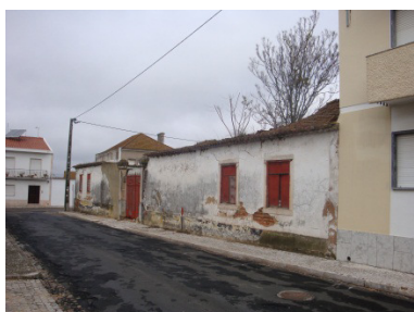
Figura 42 – Armazéns devolutos. Travessa dos Apóstolos
