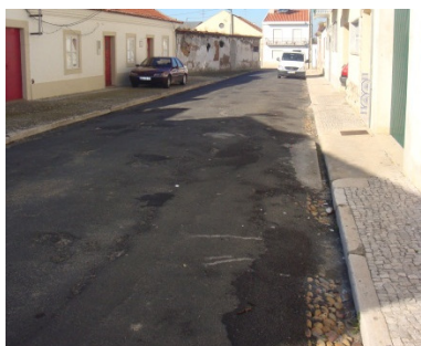
Figura 34 –Rua dos Apóstolos – Mau estado de conservação
