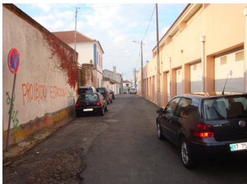
Figura 45 - Travessa do Vareta. Repavimentação em asfalto, mal executada
