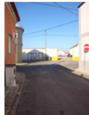
Figura 47 – Rua Miguel Minderico. Arruamento com remendos
