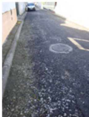
Figura 46 - Travessa das Ribeiras. Repavimentação em asfalto, mal executada
