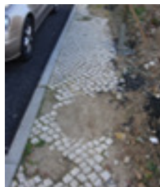
Figura 49 – Pavimento do passeio destruído – Rua da Ermida
