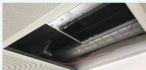
Equipamento de AVAC
