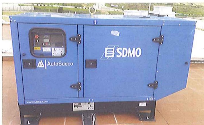
Imagem 5 – Gerador de Emergência
