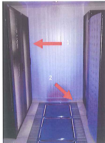
Imagem 4 – Vista frontal dos Bastidores (corredor de ar Frio)
