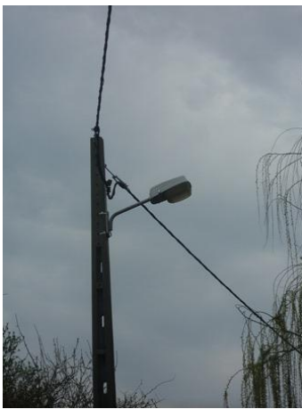
Figura 23 – Cablagens suspensas e luminárias aplicadas em postes fachadas
