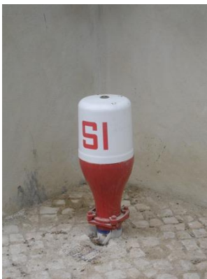
Figura 20 – Foto marco de incêndio
