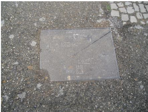
Figura 24 – Câmara de visita de telecomunicações
