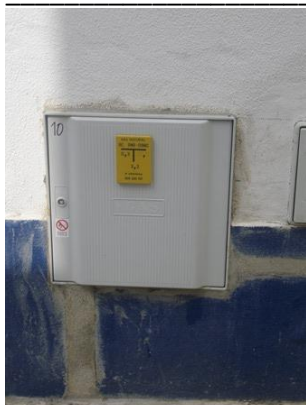
Figura 25 – Caixa técnica contador gás
