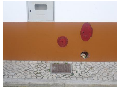
Figura 19 – Foto caixa contador AG
