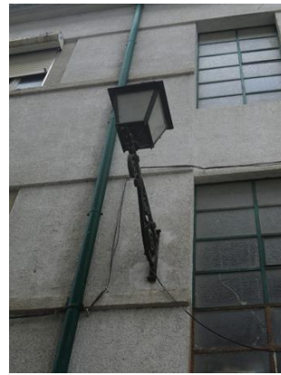
Figura 22 – Cablagens suspensas e luminárias aplicadas em fachadas
