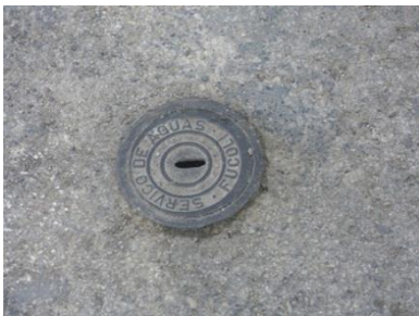
Figura 18 – Foto tampa válvula seccionamento rede AG
