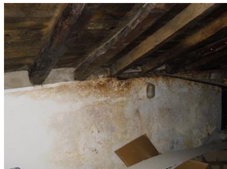
Vista do interior e respetivas patologias
