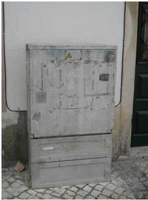
Figura 21 – Foto armário distribuição BT e IP
