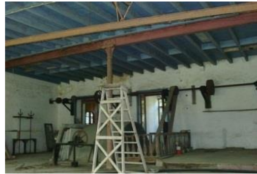
Vista do interior e respetivas patologias
